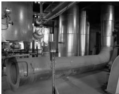
Рисунок 12. Пневматическая труба охлаждения
