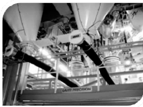
Рис 4: Дозирование в шлангах с псевдооживлением
